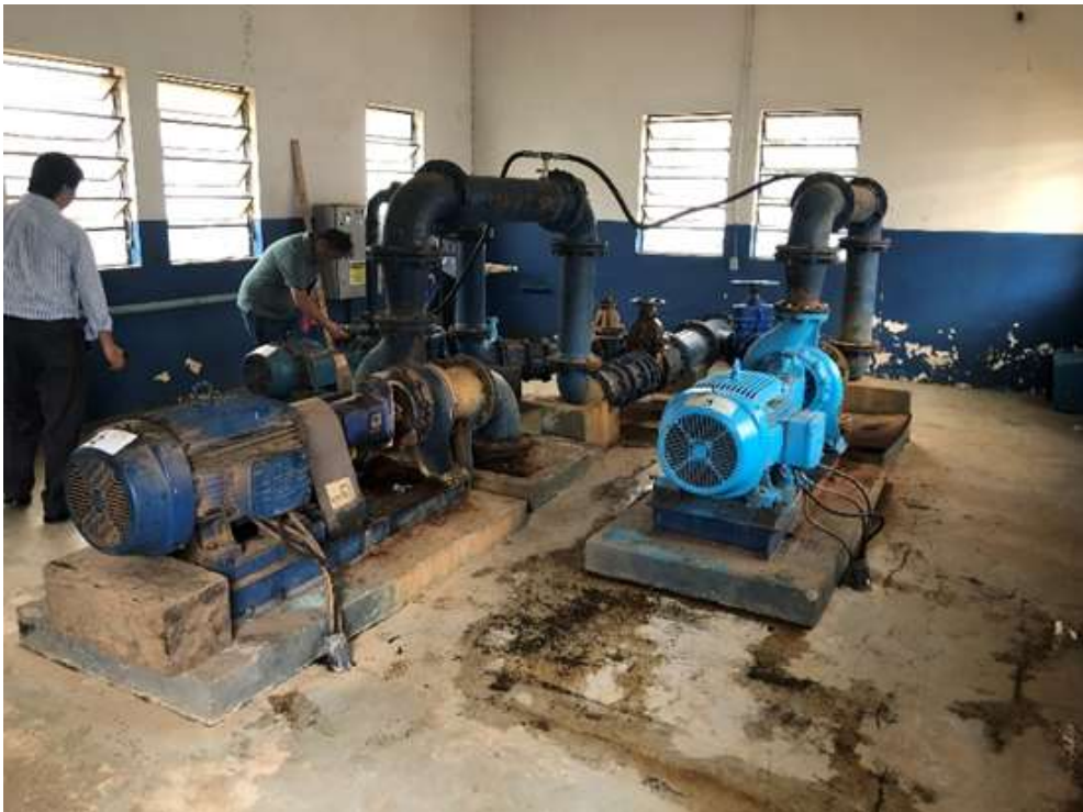
Figura 83 - Casa de Bombas EEAT ETA Velha, 2018.
