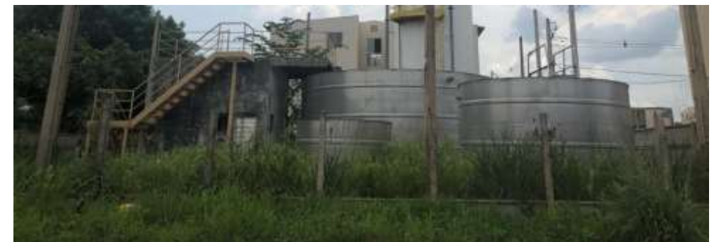
Figura 142 - ETE Porto Fino
