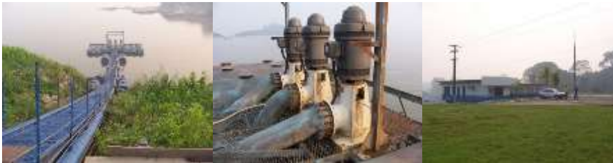
Figura 64 - Captação na represa da UHE de Santo Antônio
