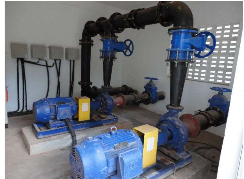
Figura 116 - Casa de bombas da EEAT do Sistema Residencial Bairro Novo
