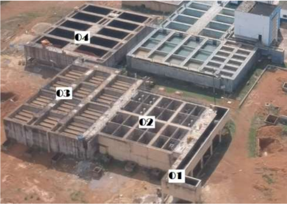
Figura 181 - Módulos de tratamento da Nova ETA, 2018.
