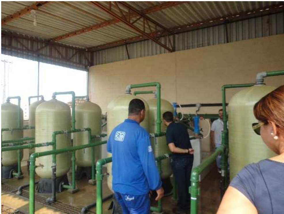
Figura 119 - Filtros do Sistema Residencial Orgulho do Madeira
