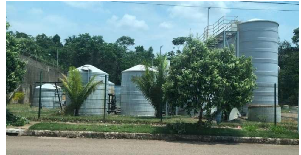
Figura 136 - ETE do Sistema Bairro Novo
