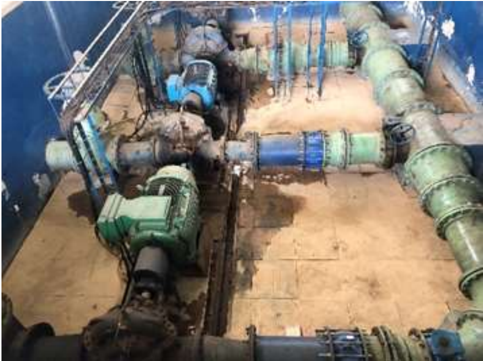
Figura 81 - Casa de bombas da EEAT 01, 2018.
