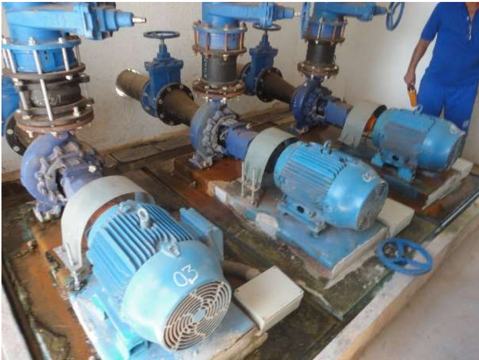
Figura 118 - Casa de bombas da EEAT do Sistema Residencial Orgulho do Madeira
