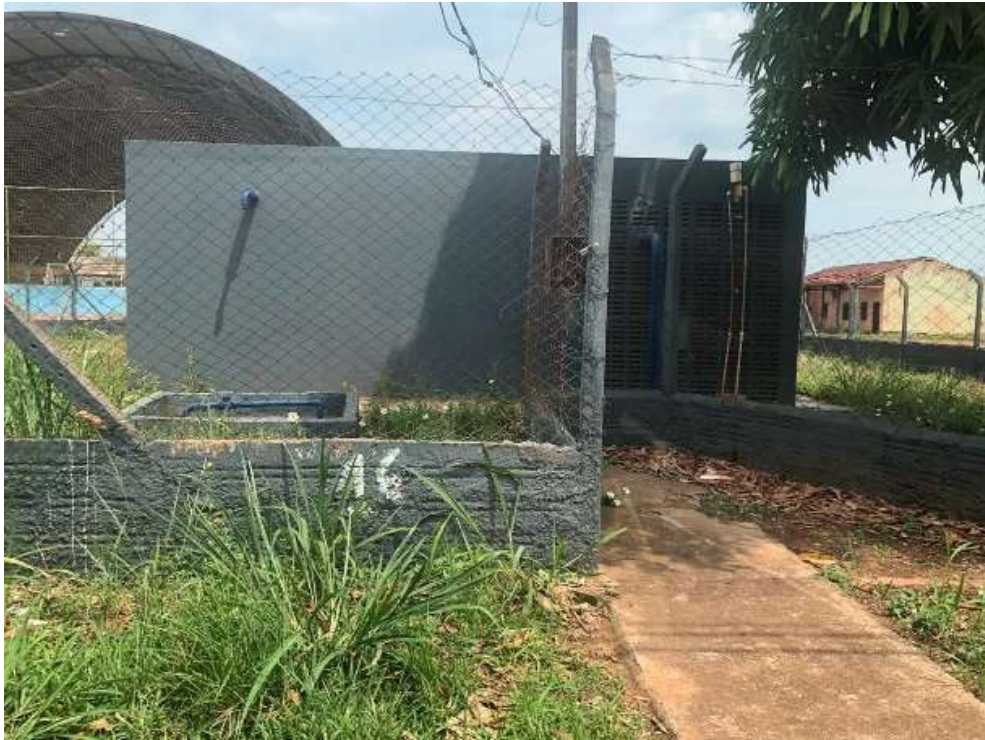
Figura 109 - Centro de Distribuição do Sistema Conjunto Jamari
